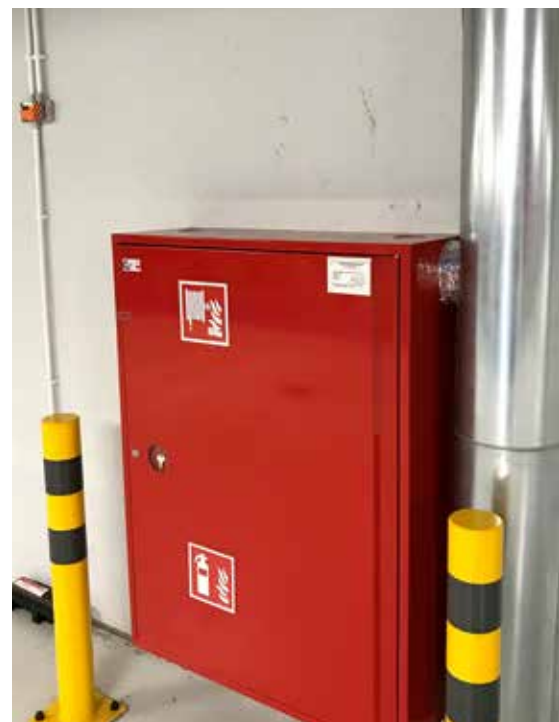
➤ Szafka hydrantowa z miejscem na gaśnicę
