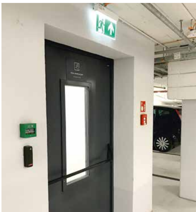
Oznakowane wyjście na drogę ewakuacyjną
