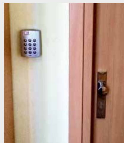
Kontrola dostępu do Centrum Nadzoru
