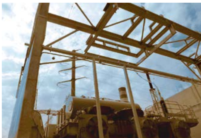
Fot. 2. Zabezpieczenie transformatora za pomocą systemu mgły wodnej (materiały własne)
