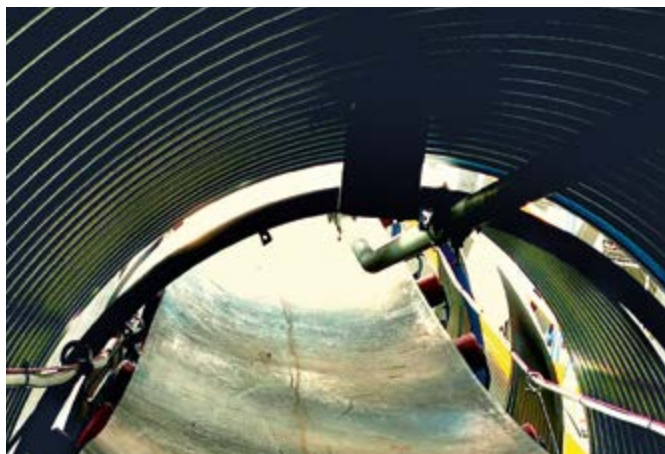
Rys. 1. Fragment taśmociągu nawęglania. Widoczne krążniki, na których przesuwa się taśma (materiały własne)
