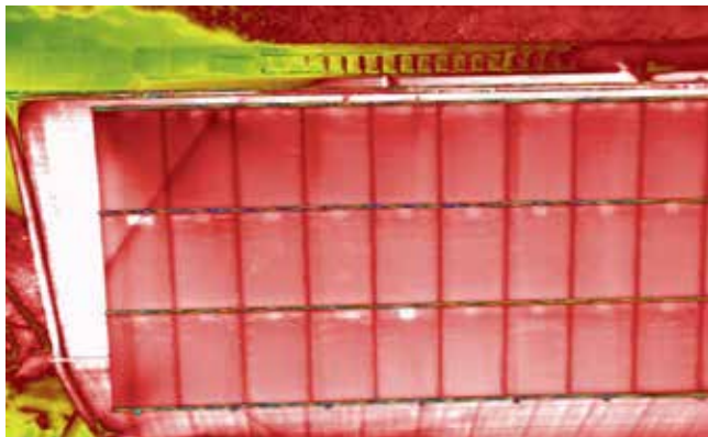
Zdjęcie wykonane za pomocą kamery termowizyjnej w trakcie inspekcji paneli fotowoltaicznych. Źródło: TEAX
